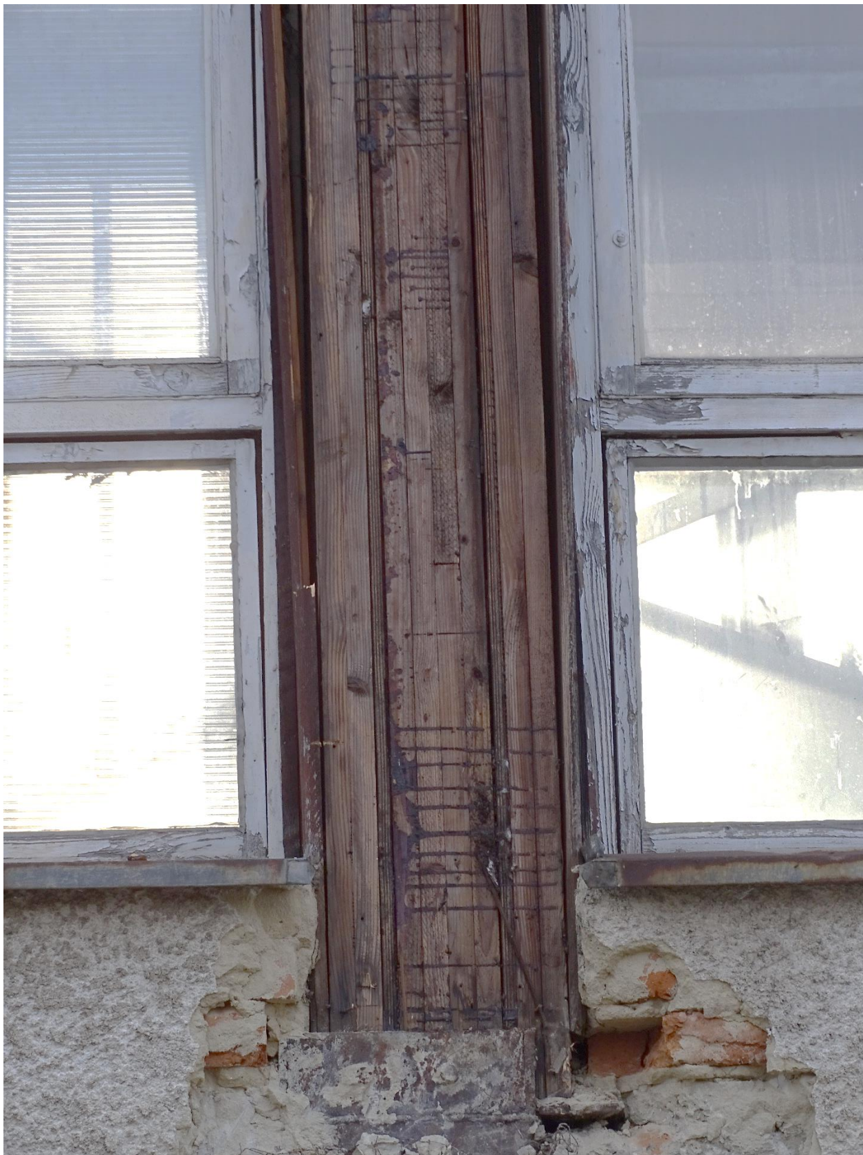
Obr. č.28 – Foto - plocha exteriérovej pásnice stípa v spodnej tretine
