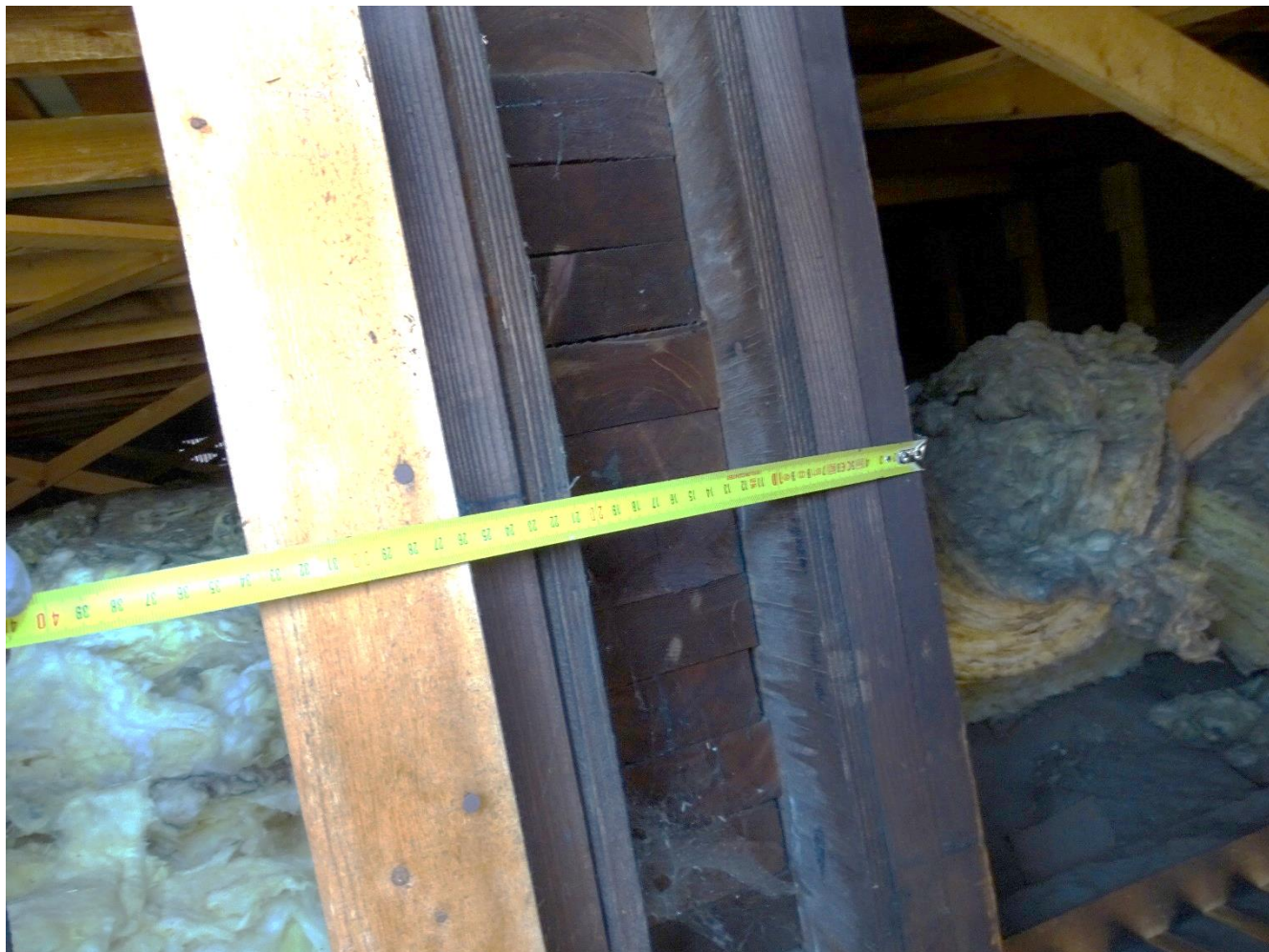
Obr. č.18 – Foto – Koncová plochy plného väzníka v rohovom tuhom rámovom styčníku
