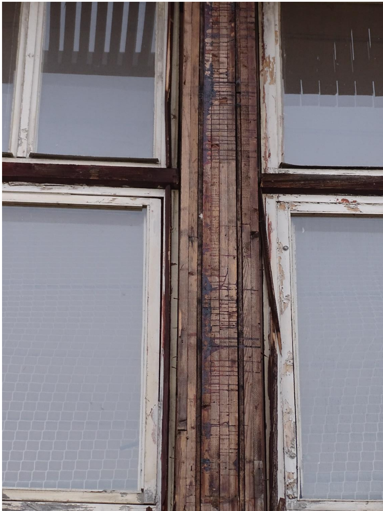
Obr. č.26 – Foto – plocha exteriérovej pásnice stĺpa v hornej tretine
